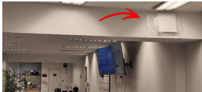
A flecha vermelha indica um dos dutos fechados pelos funcionários na tentativa de impedir a entrada da poeira da reforma
